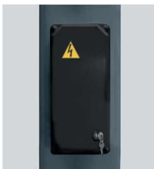
Quadro elettrico colonna secondaria.
